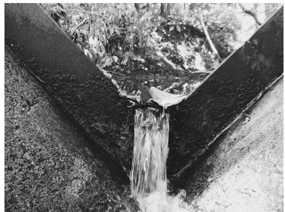
写真 1 落葉・落枝が越流部に詰まった様子。
