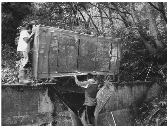
写真1 新タイプの落葉・落枝流入防止スクリーンの設置作業．
