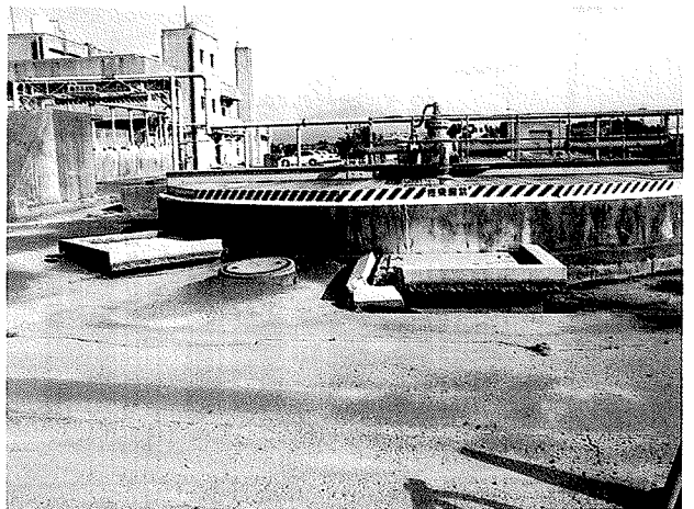
写真-5 周辺地盤の沈下
