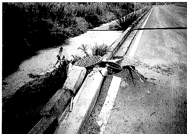
写真1 マンホールの破損
