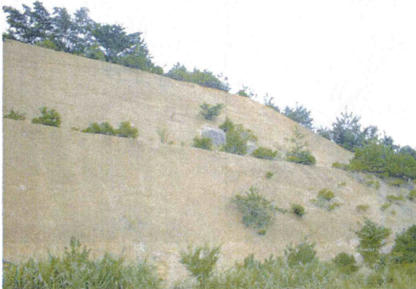
写真 2.3.15 花崗岩の切土斜面（鳥取県西伯町）
