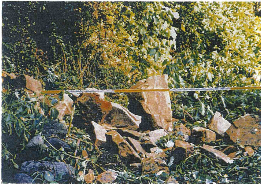
写真 2.3.10 上箇所部落石（鳥取市）
