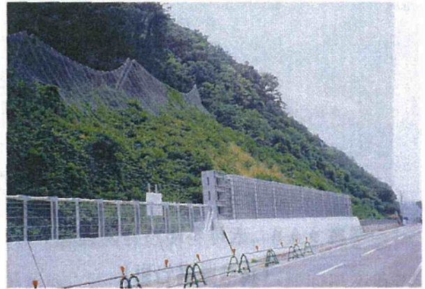
写真 3.4.5 ポケット式ロックネットと防護柵 (鳥取県溝口町)
