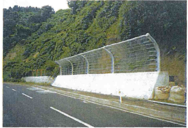
写真 3.4.9 曲柱型の落石防護柵 (鳥取県西伯町)
