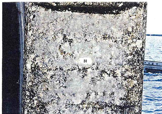
写真-5.7 干満帯柱部への電着物の析出状況 (南側柱)
