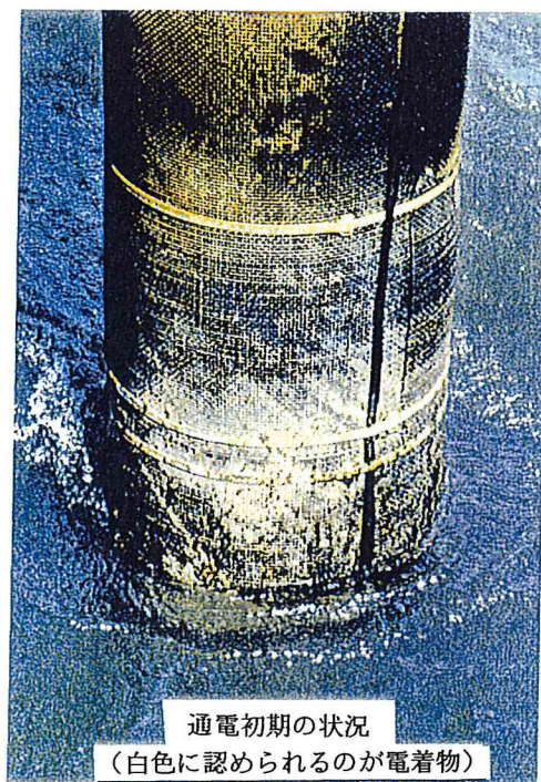
写真-5. 1 鋼管杭表面の電着物の析出状況
