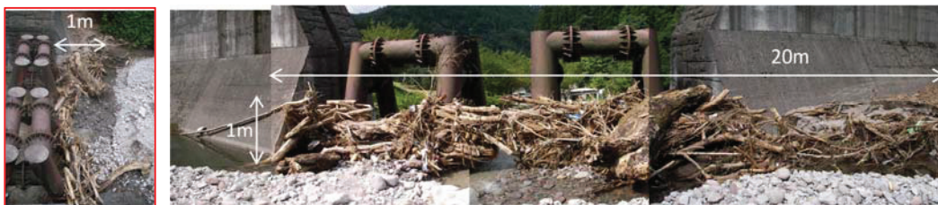
図-4.4.18 福原2号砂防堰堤の流木捕捉状況
