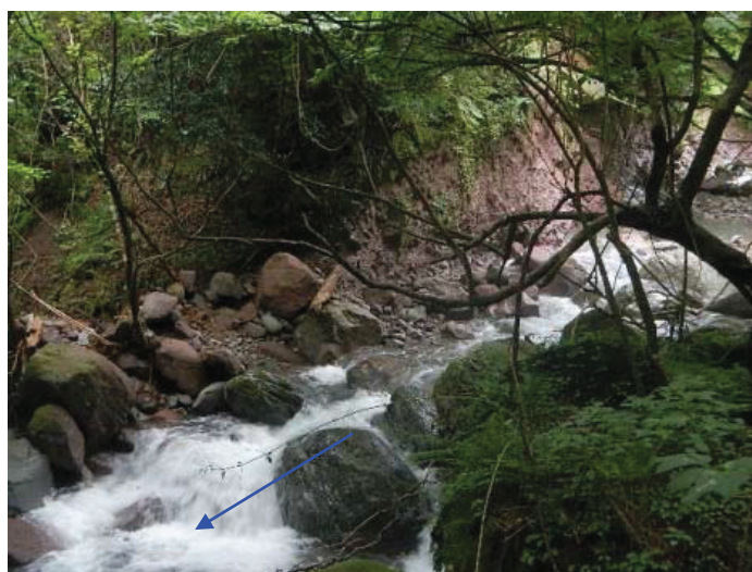
写真-4.4.2 赤岩川上流部の溪岸侵食状況 (2013年7月16日撮影)
