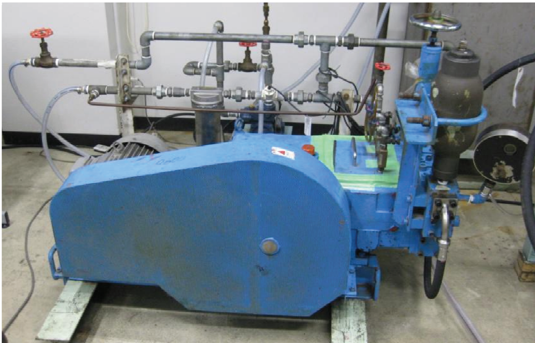
図 2.3 高圧水ポンプ外観
