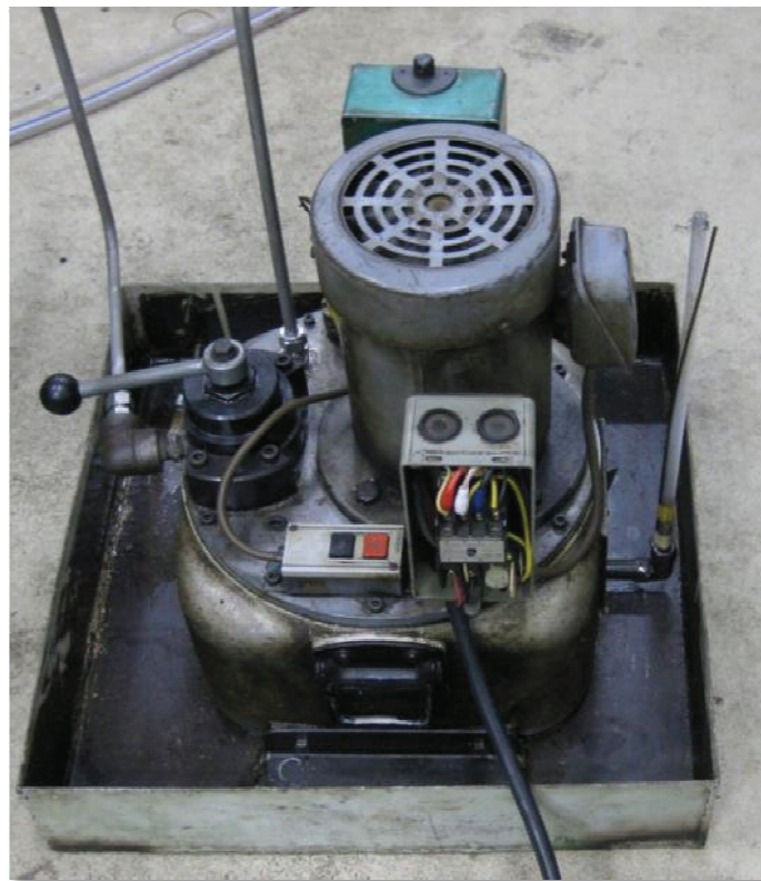
図 2.5 シール油ポンプ外観
