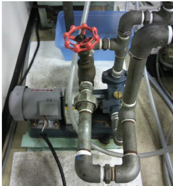
図 2.2 水供給ポンプ外観
