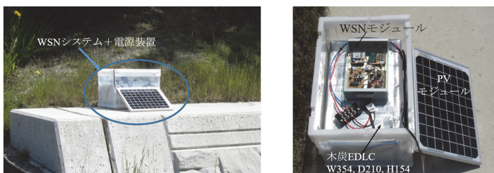
図 2.21 試作した WSN システムの設置状況と外観
