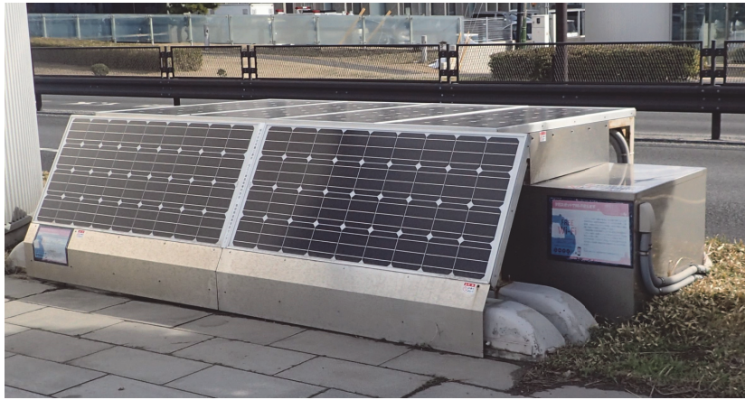
図 3.21 Wi-Fi 用電源システムの設置状況
