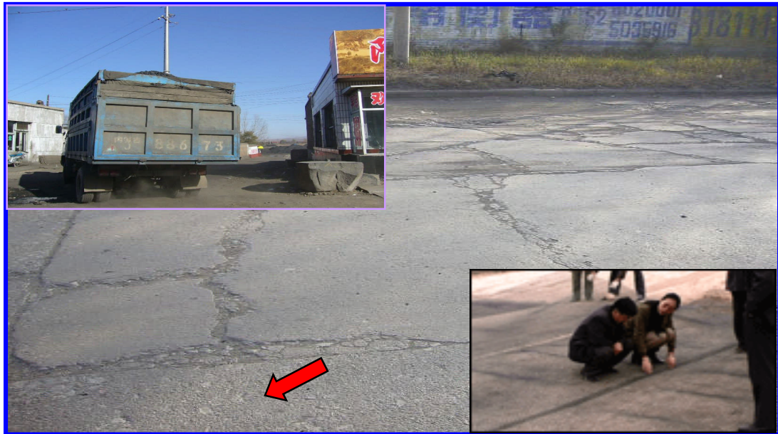
Fig.1-4 冬期における道路舗装が摩耗を受けた状況
