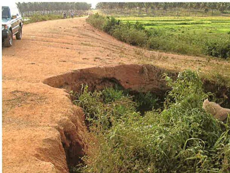
写真Ⅲ－１ ダムの陥没箇所 (Petit-Bouaké)
