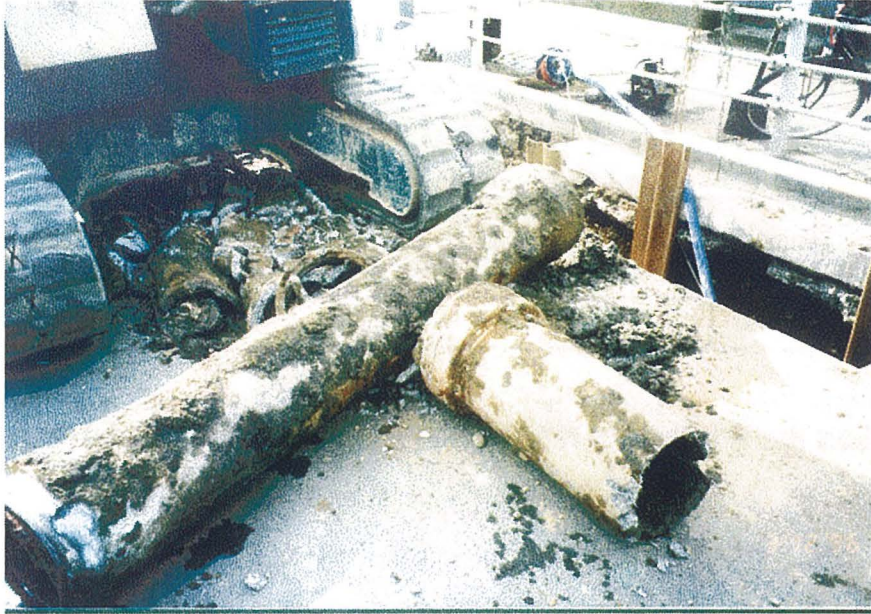
写真 2.2.1 掘り上げ時の破損鉄筋コンクリート管
