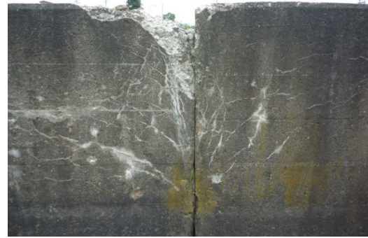
写真-1.4 開水路の目地付近の劣化事例
