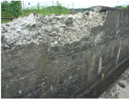
写真-1.3 開水路のスケーリングの事例
