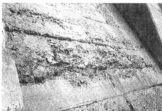
写真－1.1 ダム堤体表面のスケーリングの事例
