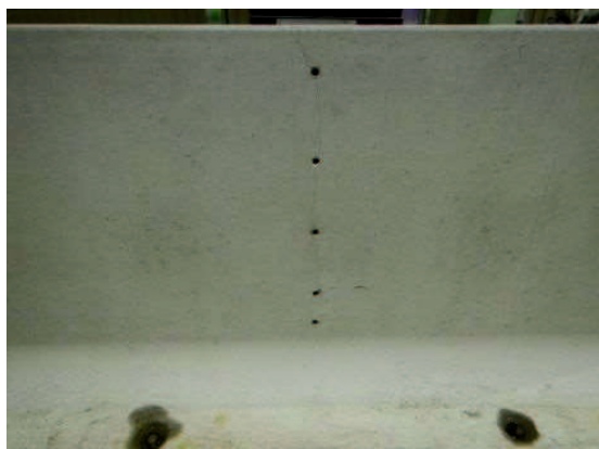
写真 4.8 ひび割れ発生状況
