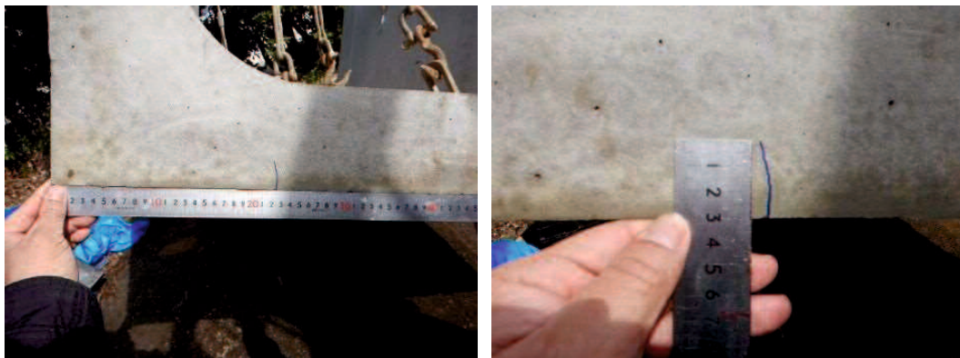
写真 5.20 ひび割れ状況（土のう側）
