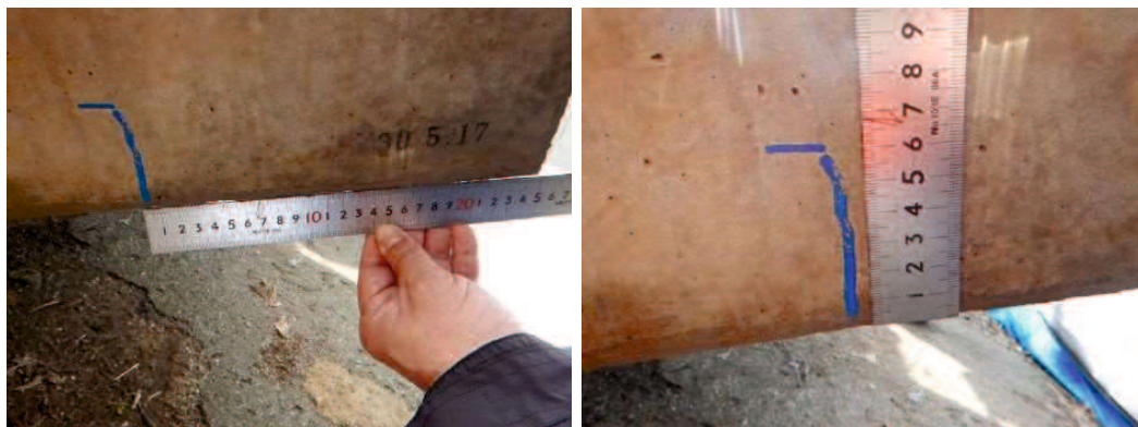
写真 5.21 ひび割れ状況（コンパネ側）
