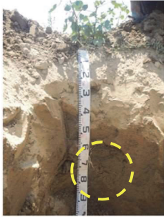
空洞部付近 (○印) が崩落して いるが柔らかい状態 (2015年8月3日)
