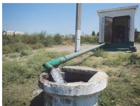
揚水中の垂直排水（配電盤は建屋内） ミルザバット地区アフメドフ WCA 内 (2015/8/4)
