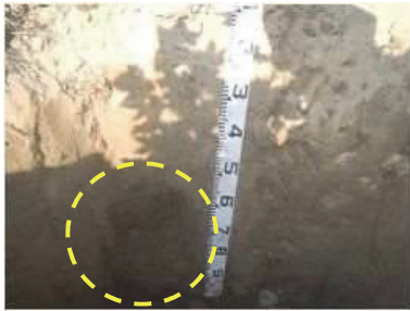
空洞部付近 (○印) は崩落して いるが柔らかい状態 (2015年7月30日)
