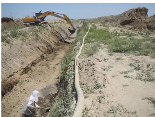
シルダリア州ミルザバット地区バルニーWCA 内でクェートファンドによる支援で建設中の暗渠排水 (2014/6/18)
