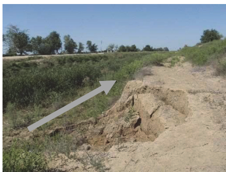
法面が崩落した排水路
