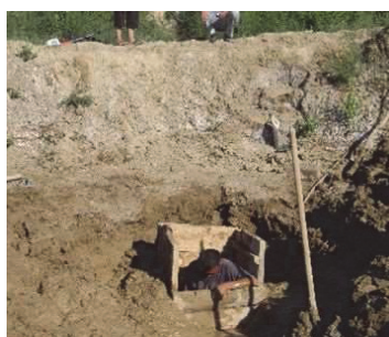
排水口 (②-a) の確認作業。 排水口の上部に 60 cm 以上の土砂が堆積
