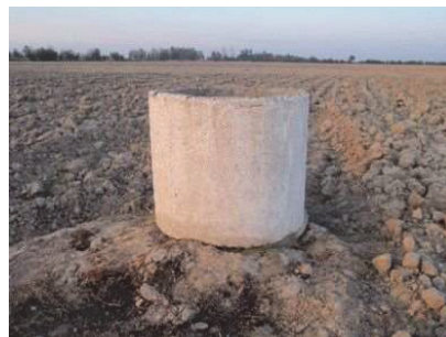
圃場中央付近 (b) に設置された暗渠排水の管理孔 (管径 1.0 m)
