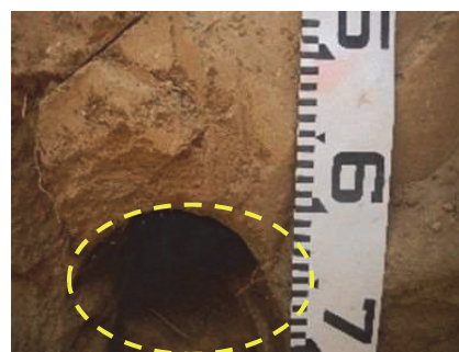
写真左の崩落部分を掻き出した状態 (2015年7月29日)
