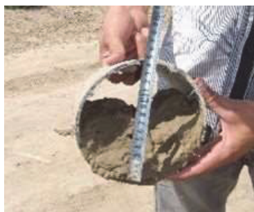
排水口 (②-a) の管内部にも土砂が堆積
