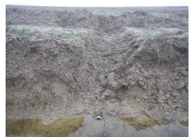
排水口付近に生じた崩落 (2015年2月24日)
