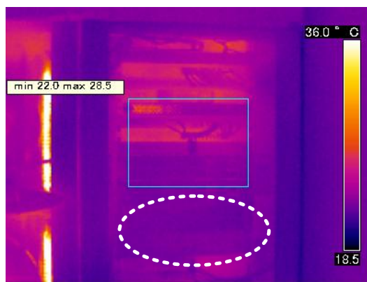
(b) 冷却システム更新後
