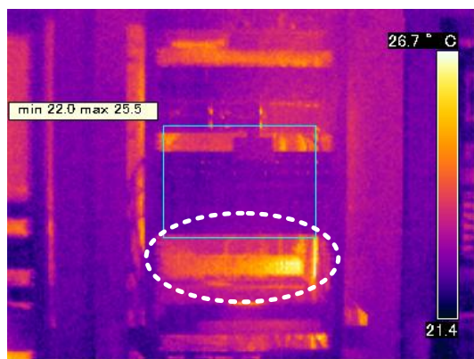
(a) 冷却システム更新前
