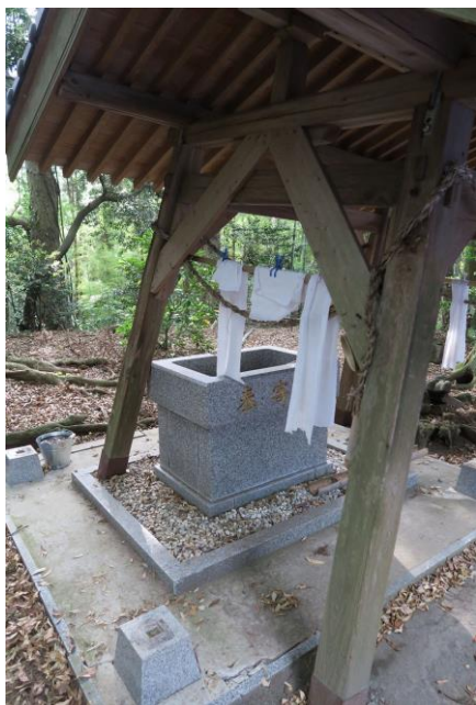
写真-3 水盤への柱部の引っかかり
