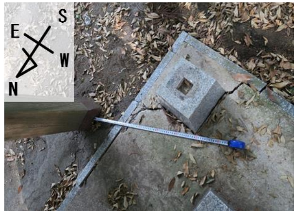
写真-2 柱基部の東石からの水平移動量 (北東方向に約 50cm)
